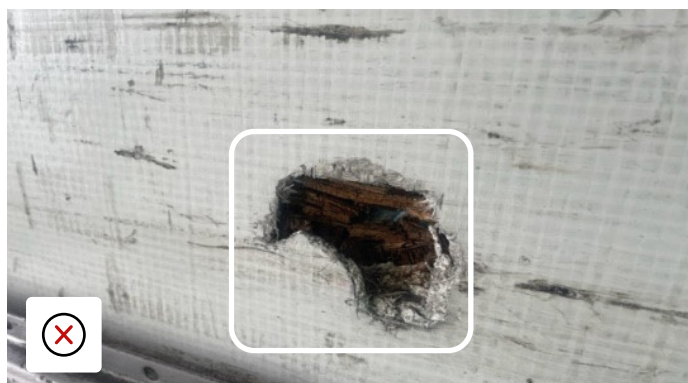
GRP panel gennembrudt og træ blotlagt
