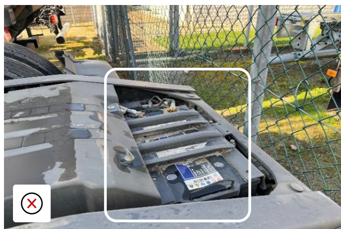
Manglende batterikasse afdækning uacceptabel
