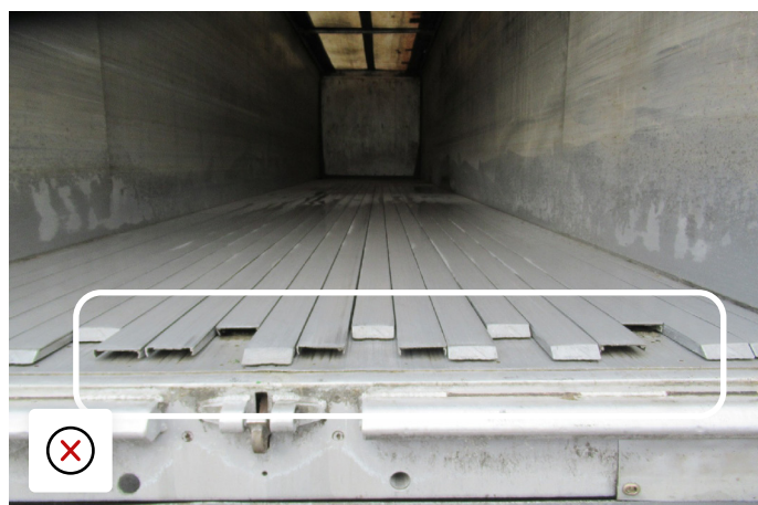
Endekappe på gulvbræt mangler - varer kan falde ned under gulvet
