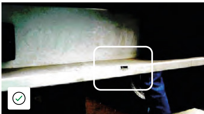
Stødskade, der ikke medfører skævhed i strukturen, og som kan rengøres og males uden større udgifter.
